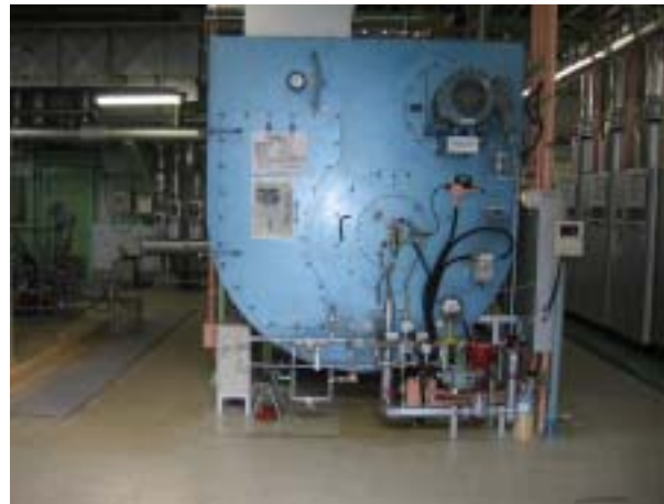
炉筒煙管 5ton ボイラー改造後
