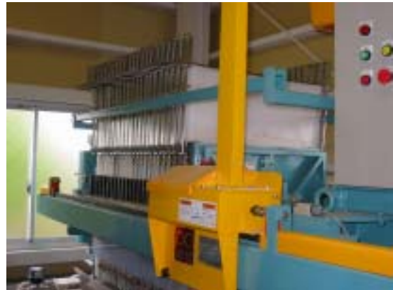
排水処理施設（脱水）
