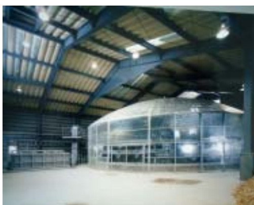
・コンポスト化機械設備
