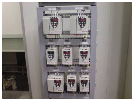
循環ポンプ 取付のインバーター
