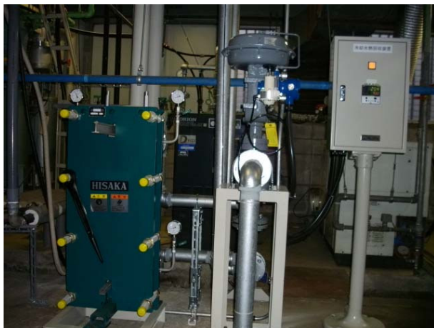
「冷却水熱回収の純水加温による重油削減」の施策で新設した熱交換装置
